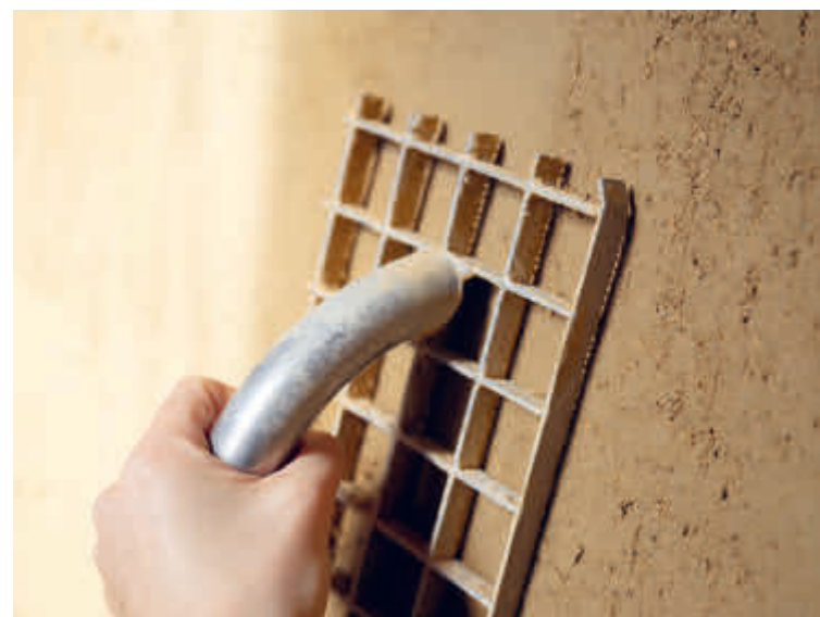
Der Einsatz von nachhaltigen Baumaterialien wie Lehmputz ermöglicht es, dem zirkulären Bauen einen Schritt näher zu kommen.
